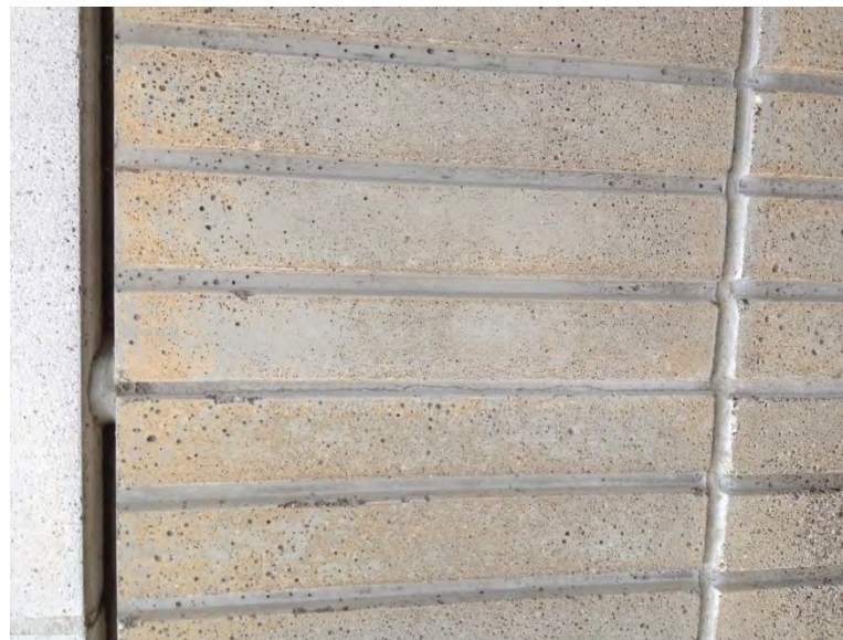
Illustration 6. Eksempel på lodret revne i fuge.
