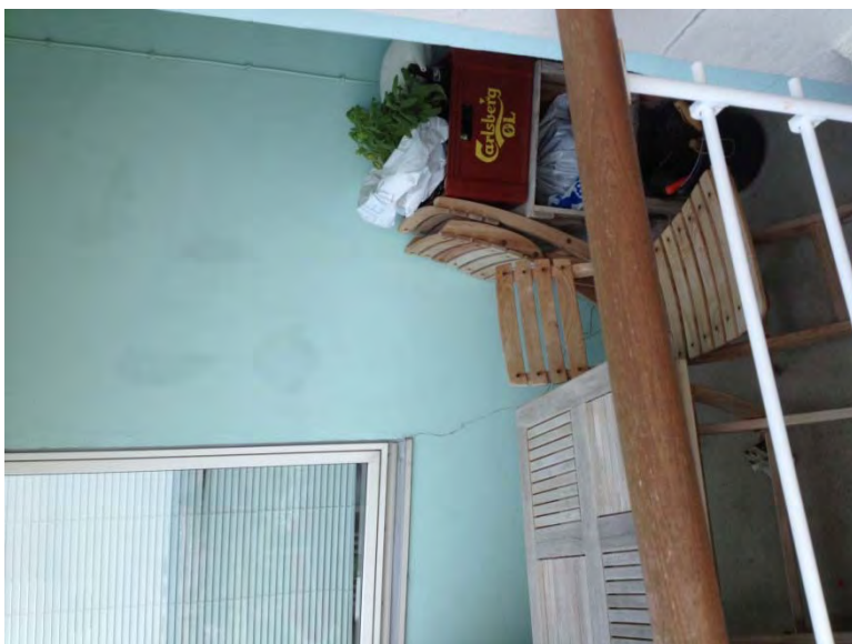
Illustration 3. Eksempel på revne i væg mellem stue og altan.
