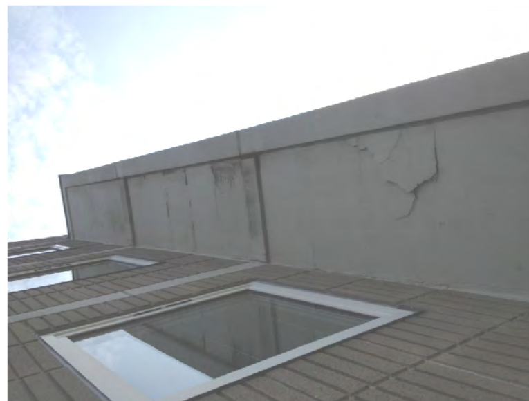
Illustration 4. Større afskalning på vestsiden ved altanside mod nord.
