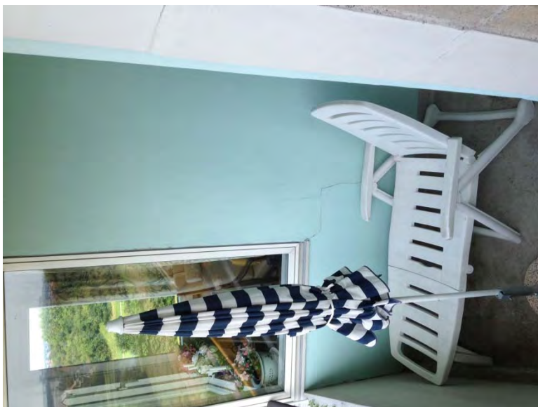
Illustration 1. Eksempel på revne i væg mellem stue og altan.
