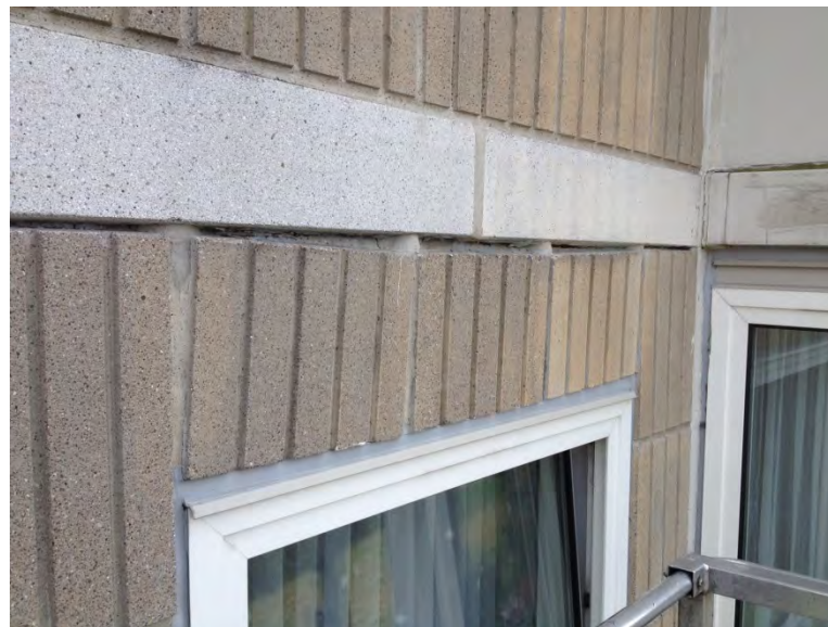
Illustration 8. Eksempel på fliser der hænger over vindue på vestsiden.
