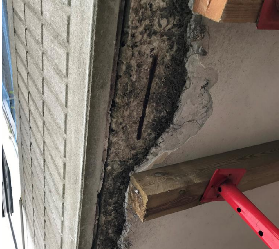
Bemærk synlig armeringsjern (fordelingsjern)
