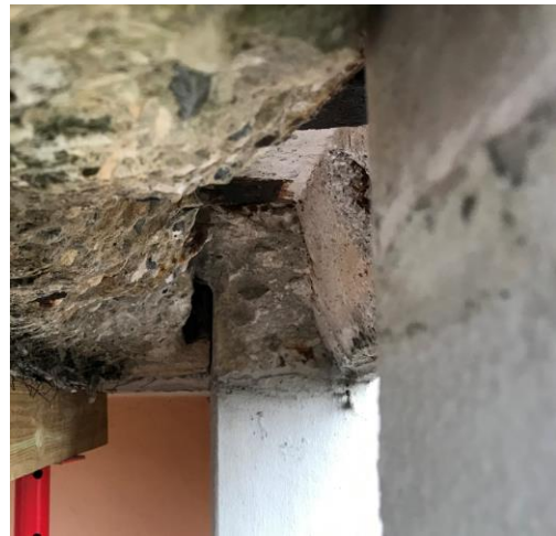
Opbygning altanplade ekskl. bærende betonplade, hvor stålplader er synlige
